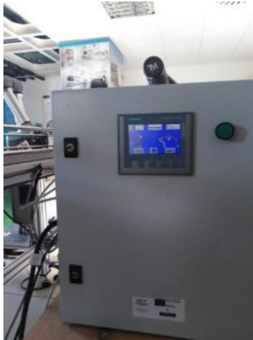
Figura 168. Detalle del armario encendido con la pantalla inicial de la interfaz desarrollada
