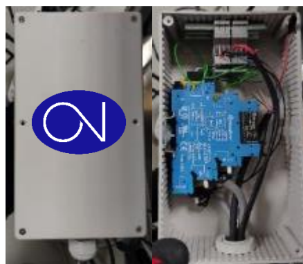
Figura 174. Caja SICK según el conexionado del Demostrador 2
