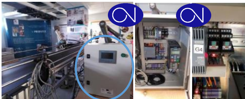
Figura 176. Armario actual – Demostrador 3
