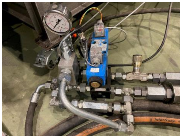
Figura 78. Control sistema hidráulico.
