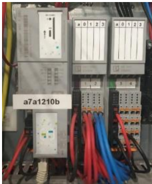
PLC PLCnext AX C F 2152 de Phoenix Contact. Versión de Hardware 02 y Firmware 2020.6.1. Módulo de entradas y salidas digitales AXL F DI8/1 DO8/1 1H y Módulo entradas y salidas analógicas AXL F AI2 AO2 1H
