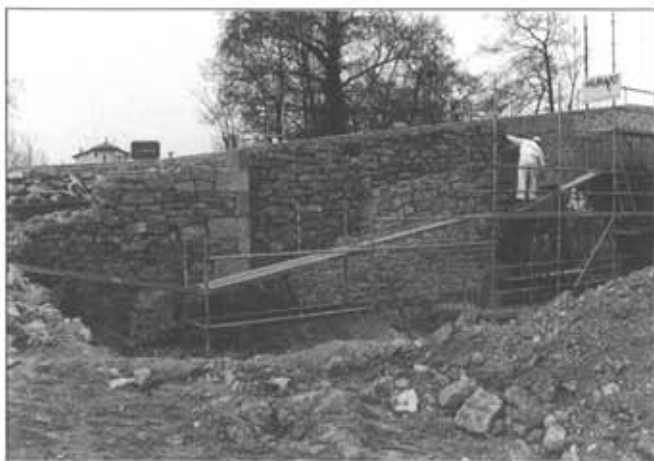
Fig. 1.-Aspecto del puente durante las obras de restauración. Pueden observarse diferentes unidades estratigráficas murarias correspondientes al arco izquierdo aguas arriba.
