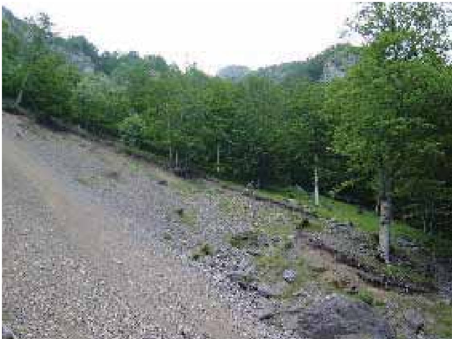
Ladera que muestra la cicatriz del movimiento en masa, afectando a un canchal en la pista que comunica el pueblo de Bezares con la majada de Brañagallones. J. E.
